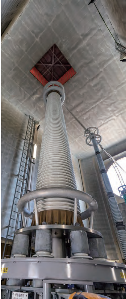
ケーブルヘッドの建屋内部にある碍子。
