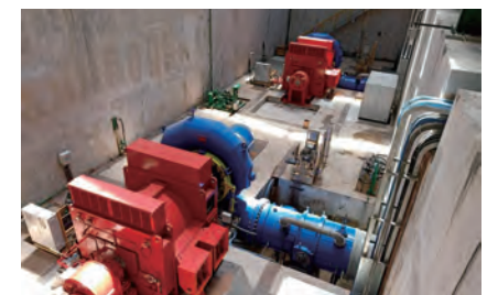
Sion発電所 内観
