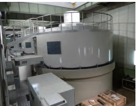
発電所内部（発電設備）
