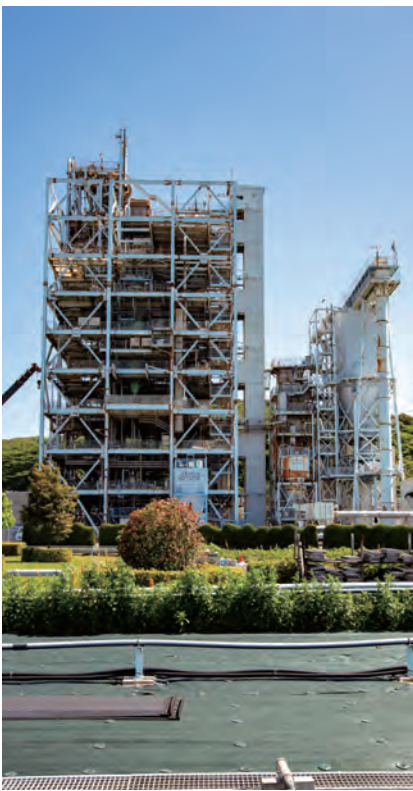
J-POWER 若松研究所内にある石炭ガス化の実証実験装置。
