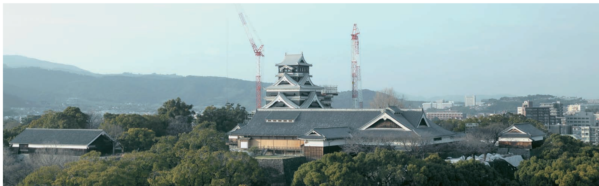
懸命な復旧工事が進む熊本城。地震で石垣や小規模な櫓が崩壊した。
