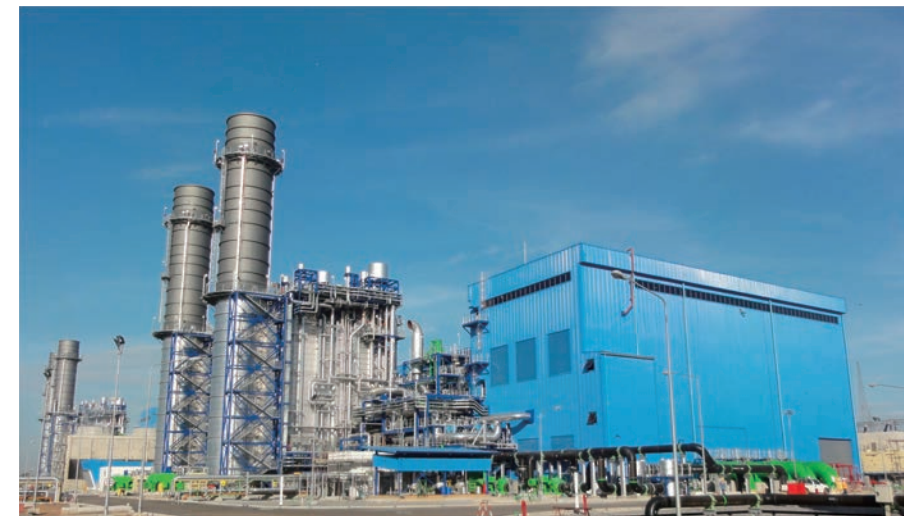
写真左奥：1号系列、写真手前：2号系列
