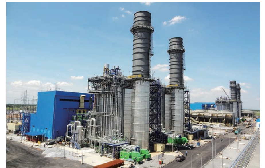
ウタイガス火力発電所（写真手前：1号系列、写真右奥：2号系列）
