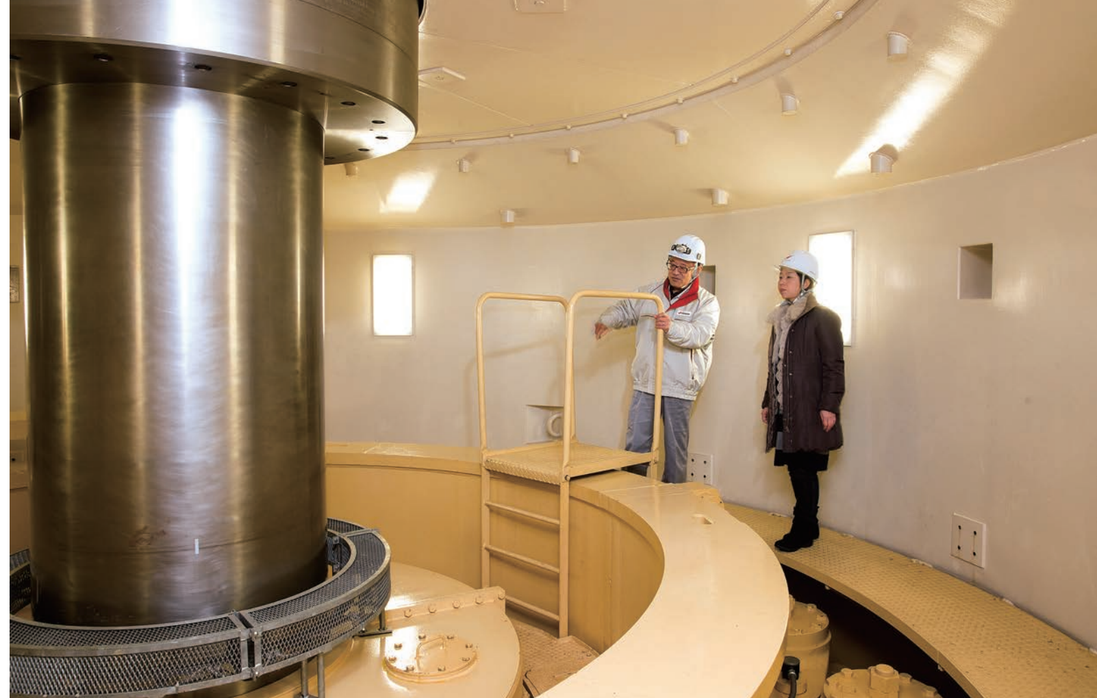
発電機の内部に入り説明を受ける
