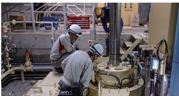
J-POWER 胆沢第一発電所(岩手県) 国土交通省の胆沢ダム建設とともに発電所の建て替えを行い、2014年7月より運転開始。発電所建設の技術継承の現場ともなった。
