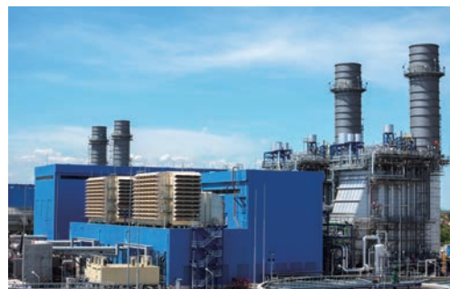
写真手前:1号系列、写真左奥:2号系列
