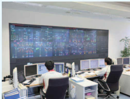
管内17カ所の発電所を監視する制御室。
