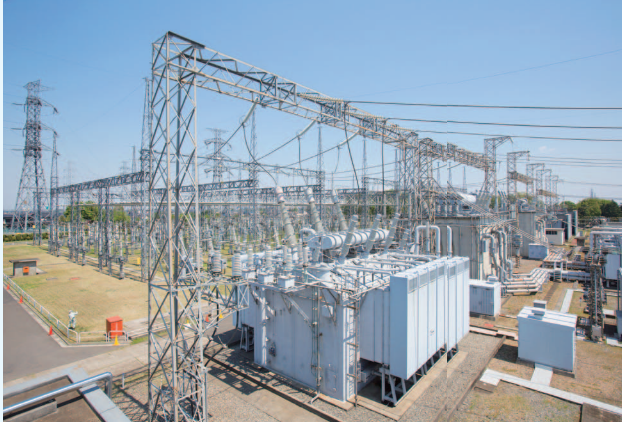
電圧を変換する変圧器（手前）と大きな電流を遮断する遮断器（後方）。
