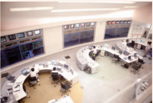
100インチスクリーン6面を設置した運転センター。
