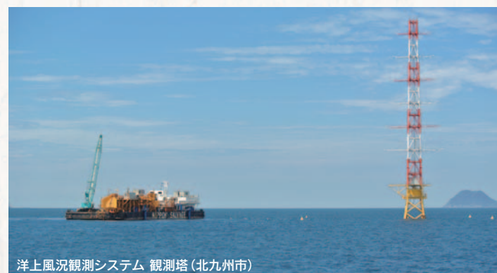
洋上風況観測システム 観測塔(北九州市)
