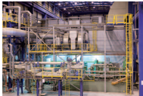
ガスタービン。燃焼したガスでタービンを回す。
