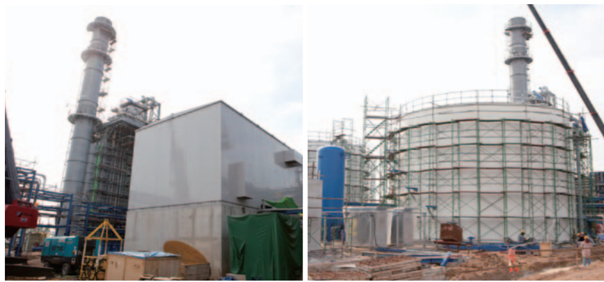
蒸気発電機の建屋。
