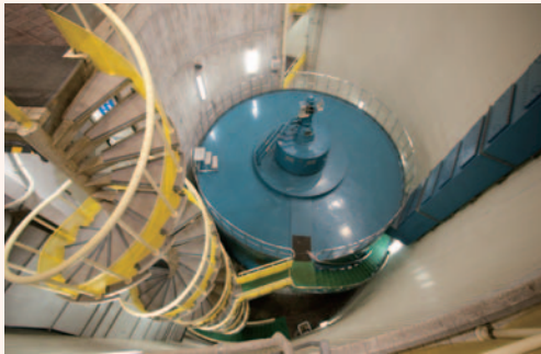
発電機は魚梁瀬発電所の心臓部だ。
