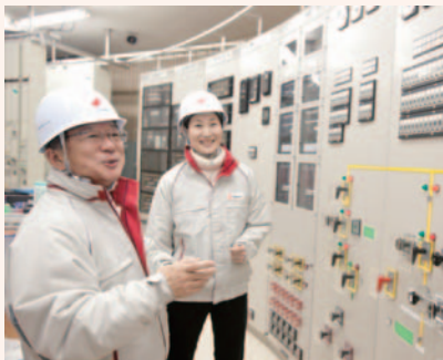
計器がずらりと並ぶ配電盤室。
