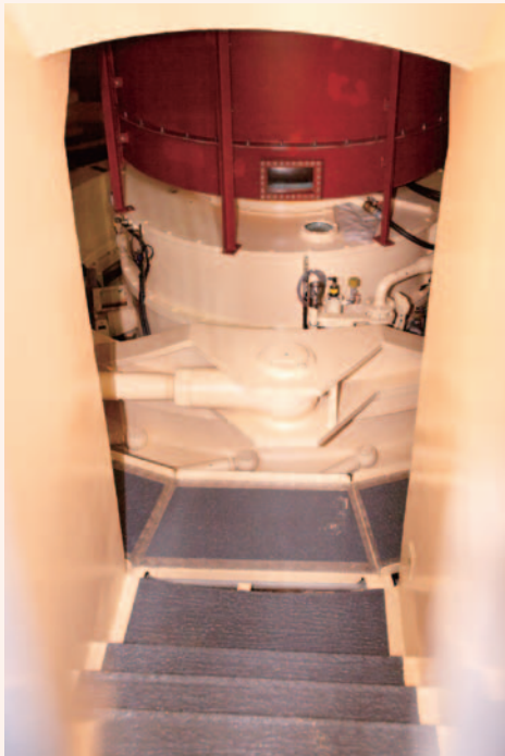
轟音が響く発電機内部。
