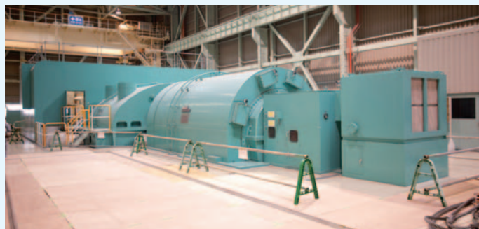
順調に運転を続ける発電機(1号機)。
