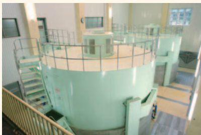
リニューアル工事の終わった発電機。
