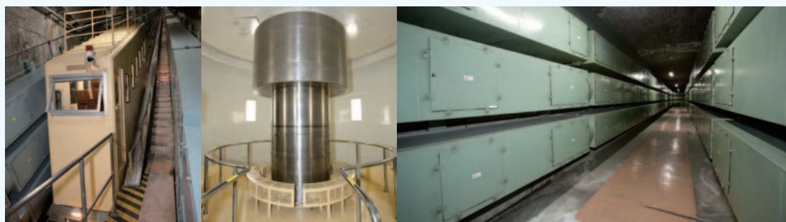
右から、両サイドに送電線が通る地下通路、発電機軸、作業者が地上と行き来するためのインクライン。
