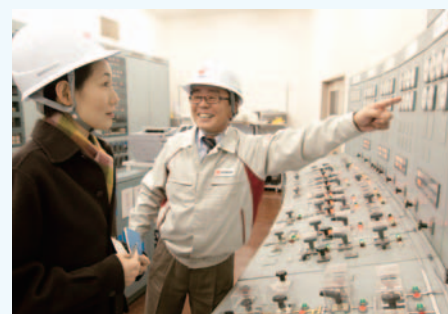
地下にある配電盤室。現在は遠方制御されている。
