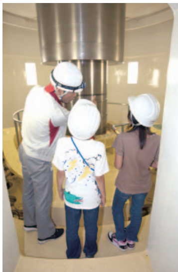
巨大な水力発電機の回転軸。毎分225回転の猛スピードで回っている。
