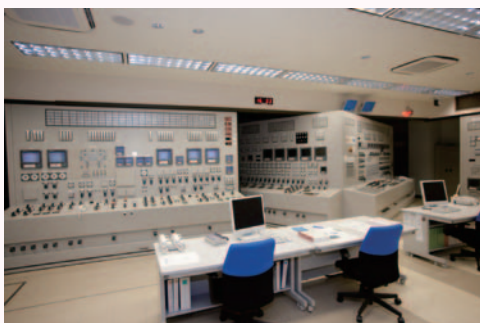
パネルが回転して各火力発電所の運転制御室も再現できる。
