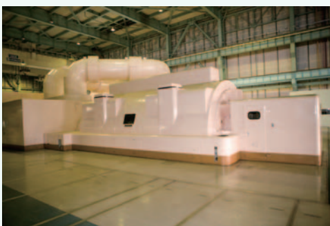
3号機の蒸気タービン・発電機。
