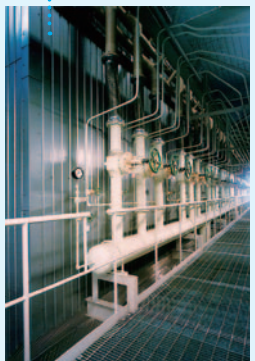
乾式排煙脱硝装置
