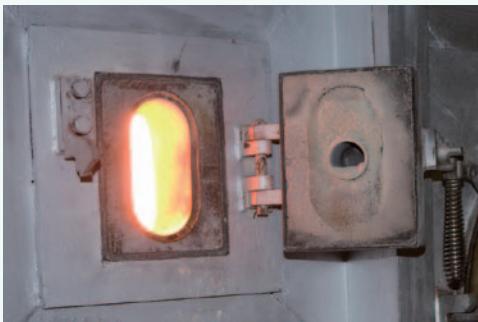
ボイラーの中ではオレンジ色の烈火が燃える。
