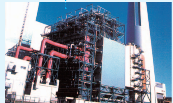
乾式排煙脱硫装置
