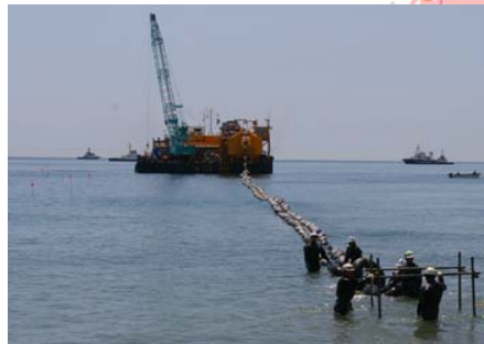
Kitahon HVDC Link
