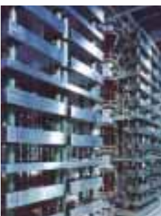
Kitahon HVDC Link
