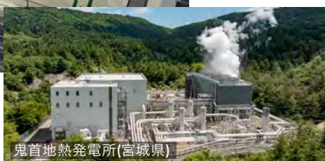
鬼首地熱発電所 (鳴子けしをあらったタービン・発電機)
