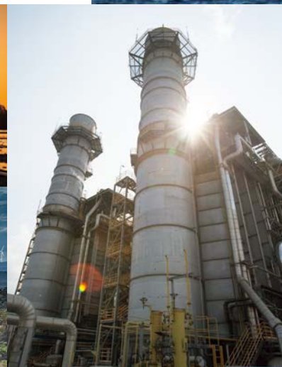
カエンコイ2ガス火力発電所(タイ)
