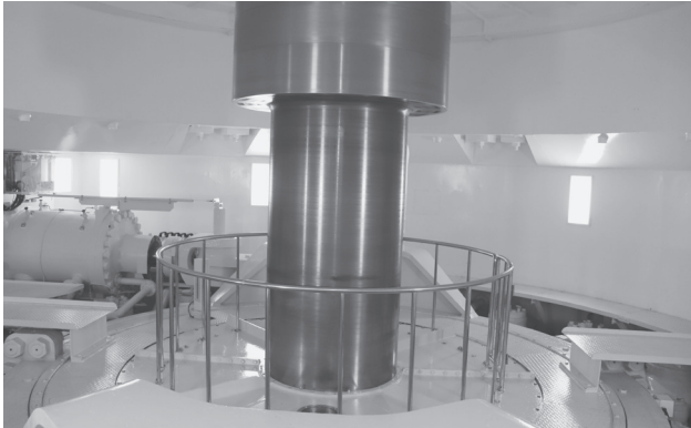
勢いよく回る発電機の回転軸（長野発電所）。揚水時には逆回転する
