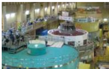
水車発電機の一括更新工事による発電出力、電力量を向上(糠平発電所、田子倉発電所にて実施)
