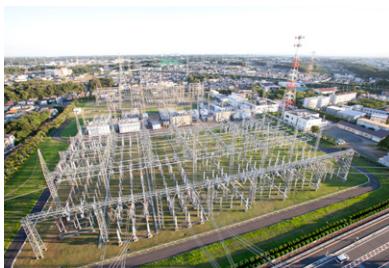
南川越変電所
