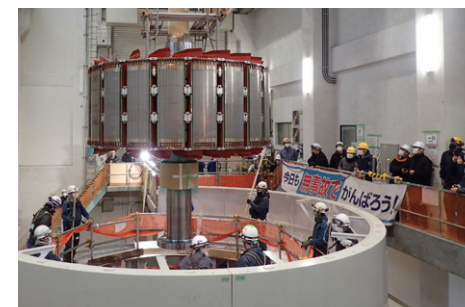
足寄発電所1号機
