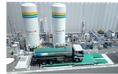
大崎クールジェンの液化CO 2 製造設備
