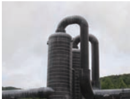
蒸気と熱水を分離する気水分離器
