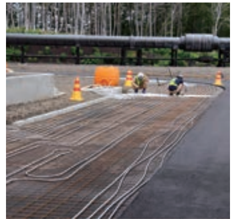
発電所本館の周辺ではロードヒーティングを設置
