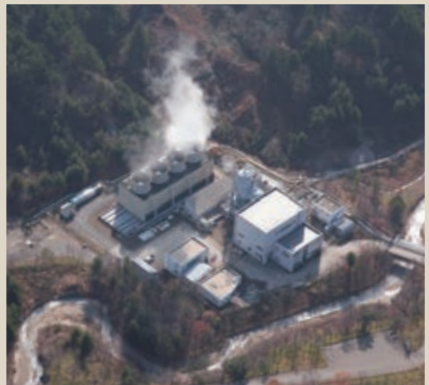
鬼首地熱発電所(現在は運転を停止し、更新に向けて環境アセスメント実施中)
