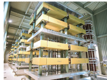
佐久間周波数変換所 (既設・静岡県)
