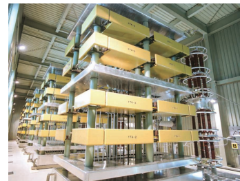
佐久間周波数変換所 (既設・静岡県)
