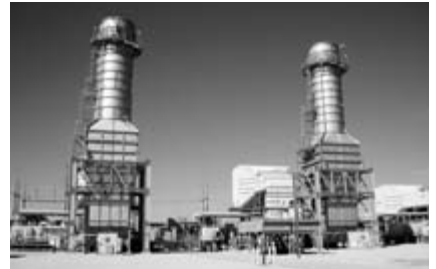
エルウッド・エナジー発電所
