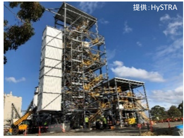
褐炭ガス化炉設備
