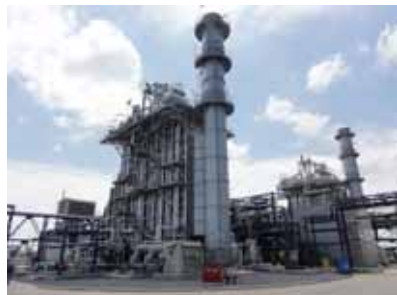
CRN (2013年7月、運転中)
