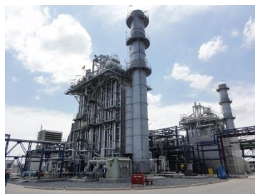
CRN (2013年7月、 運転中 )
