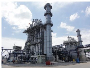
CRN (2013年7月、運転中)
