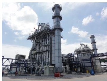
CRN (2013年7月、運転中)
