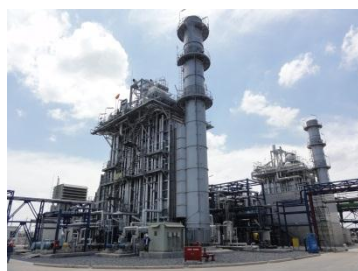
CRN (2013年7月、運転中)
