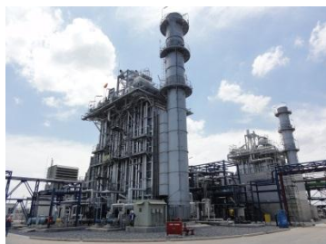
CRN (2013年7月、 運転中 )
