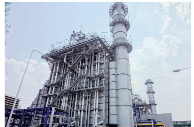
サラブリTLCコジェネレーション発電所(タイ国)
