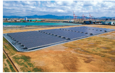
響灘太陽光発電所
