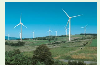
郡山布引高原風力発電所(福島県)
