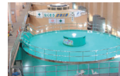
運転を再開した田子倉発電所4号機
