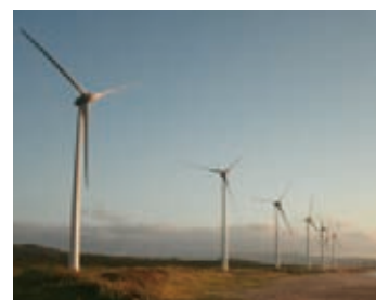
由利本荘海岸風力発電所（秋田県）
