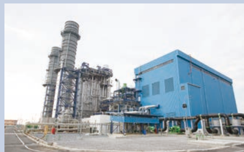
ウタイガス火力発電所(タイ)
