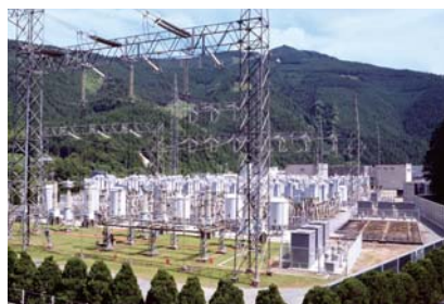
佐久間周波数変電所
