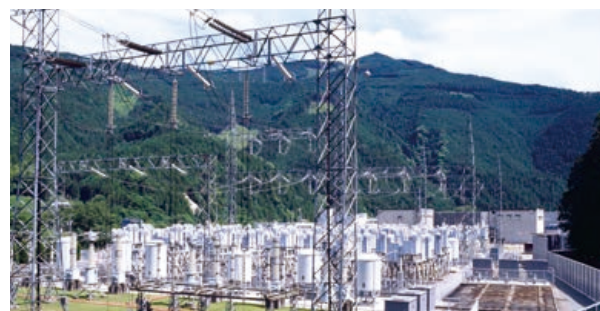
佐久間周波数変電所
