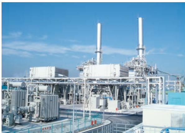
バイサイドエナジー市原発電所(千葉県)
