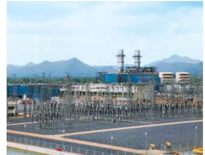
カエンコイ2発電所
