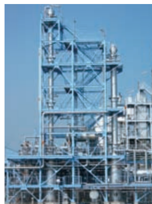
CO 2 分離回収設備
