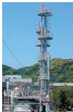
松島火力発電所2号機におけるCO 2 分離回収実証試験設備
