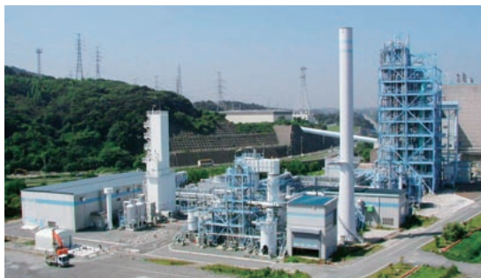
EAGLEパイロット試験設備 (若松研究所・福岡県)
