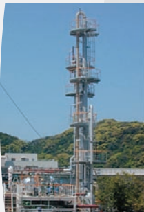
松島火力発電所2号機におけるCO 2 分離回収実証試験装置
