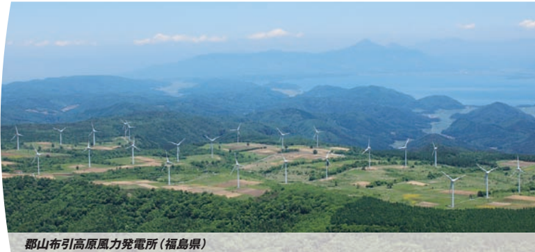
郡山布引高原風力発電所(福島県)
