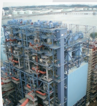
礮子火力発電所新2号機乾式排煙脱硫装置
