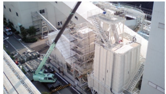
木質バイオマス受入れ設備(松浦火力発電所/長崎県)
