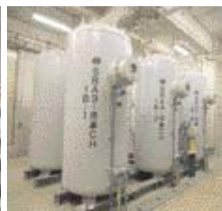
電力ケーブル用の油タンク。
